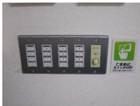
事務室照明スイッチ付近に掲示
