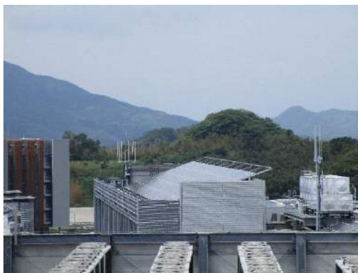
建物屋上の太陽光パネル
