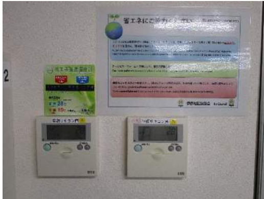
空調机付近に省エネポスターの掲示
