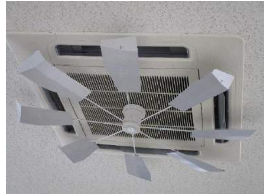
羽根による空調機の効率化
